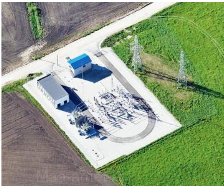
Joonis 5. 110 kV alajaama illustratsioon - Jäneda alajaam. Allikas: Maa-amet Kaldaaerofoto https://fotoladu.maaamet.ee/foto=4699103
